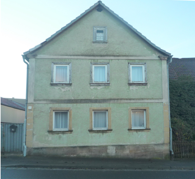
Bestand: Wohnhaus mit sanierungsbedürftiger Fassade
