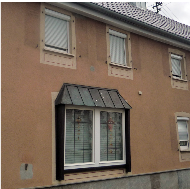
Negativbeispiel: unpassende Fenster, aufgeklebte Sprossen, aufgesetzte Rollladenkästen
